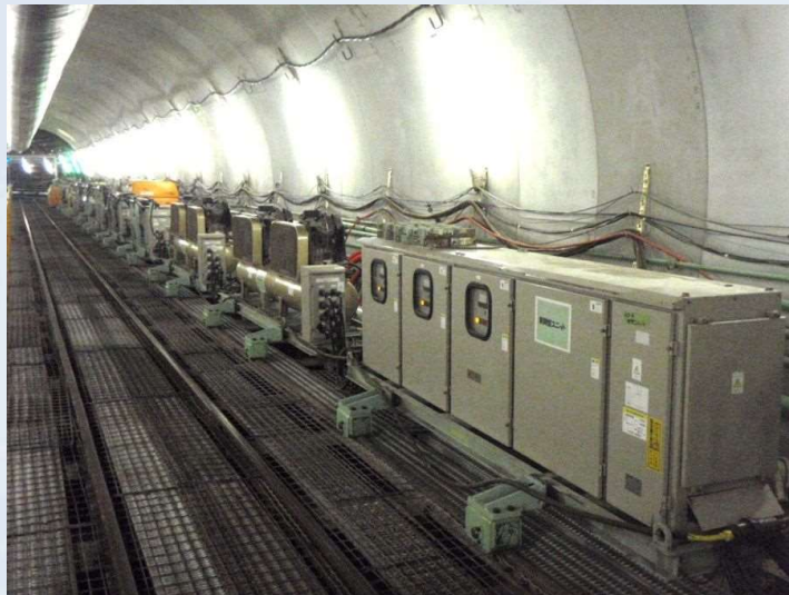
写真-1 超高压発生装置台車全景
