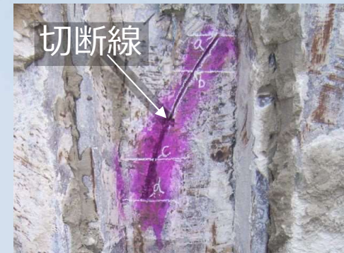
写真-1 切断線状況
